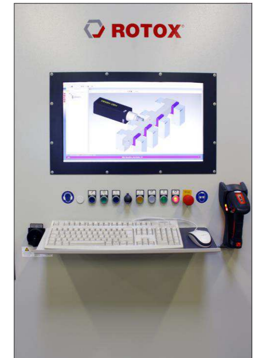
Armoire électrique avec panneau de commande
